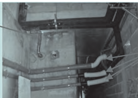
Connessione flessibile dell'impianto del gas
